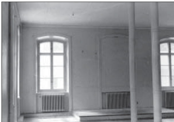
Det analytiska laboratoriet på bottenvåningen, akademiens nuvarande sessionssal 1970. För att bära upp det stora bjälklaget utan att behöva stödväggar använde Scholander fyra smäckra kolonner i gjutjärn. Med undantag för det tunna innertaket med skivor hade nästan inget av den fasta interiören förändrats under tidens lopp. Dokumentationsfotografi inför rivningen av interiören. Foto i KSLA:s arkiv.
